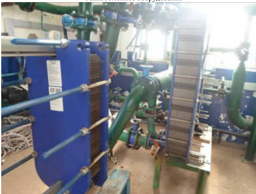
Видимое изображение №3 Теплообменное оборудование
