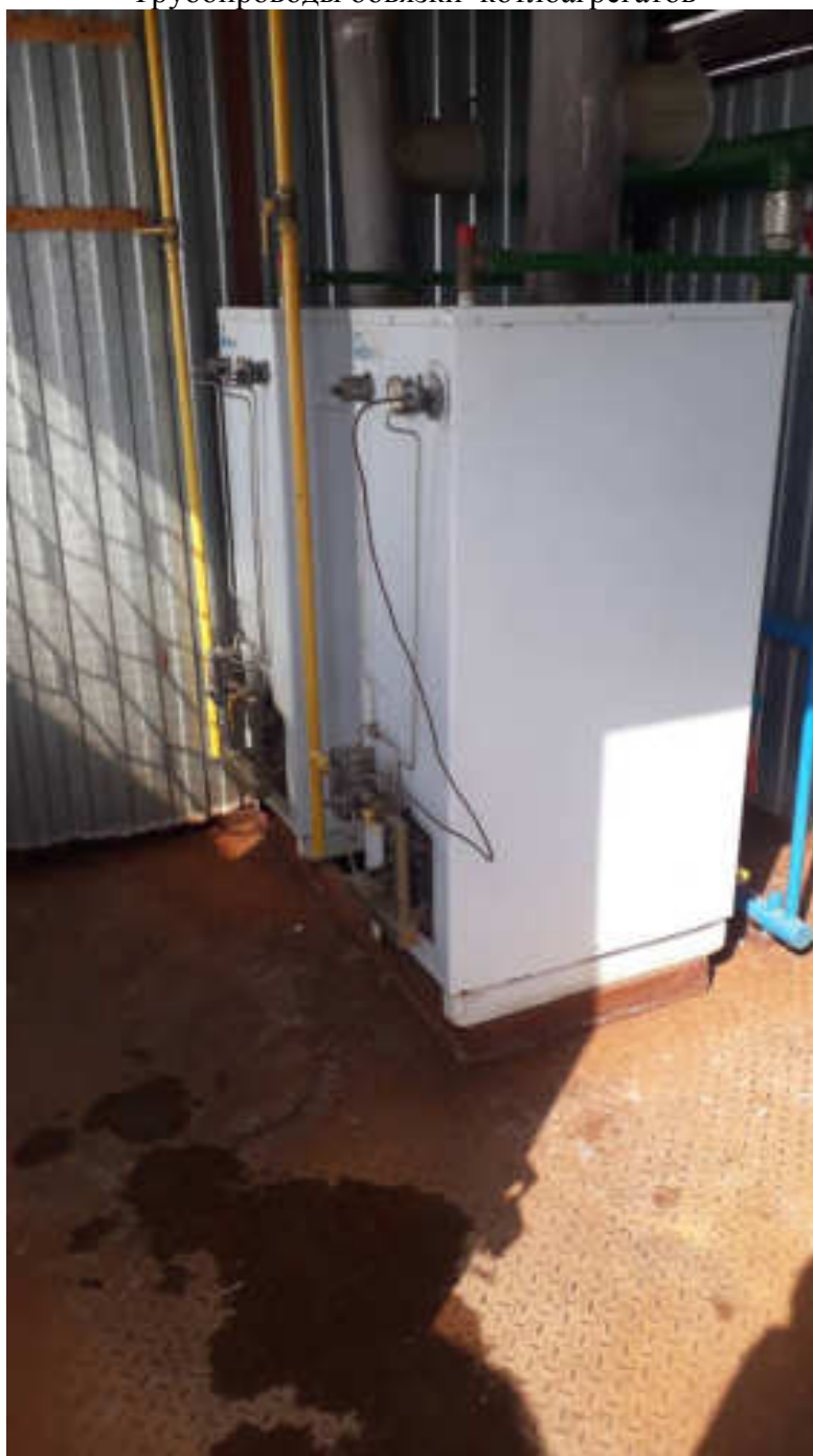
Видимое изображение №3 Трубопроводы обвязки котлоагрегатов
